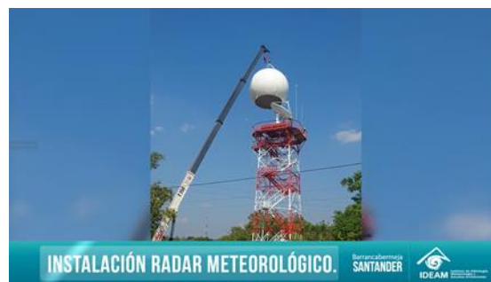
Imagen video – Instalación Radar del IDEAM en Santander – Estrategia para Redes Sociales #Tecnología para la Prevención
