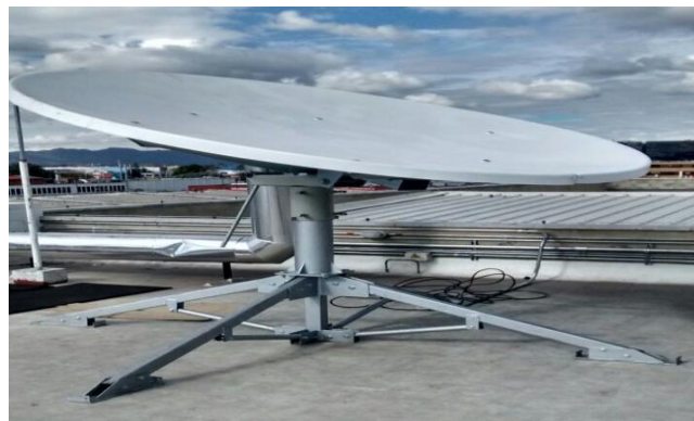
Antena de recepción de Geonetcast ubicada en las instalaciones del Ideam
